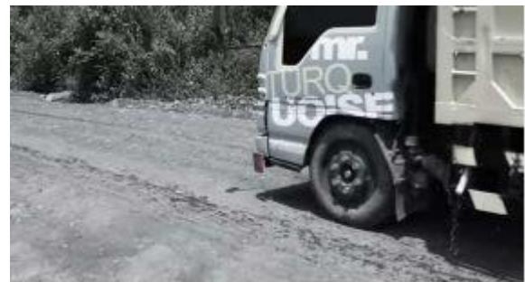
Gambar 4. Kondisi jalan angkut yang tidak memiliki paritan
