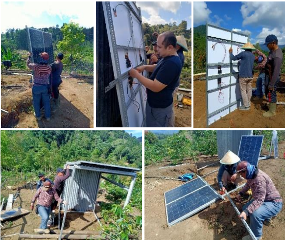
Gambar 3 Instalasi PLTS komunal
