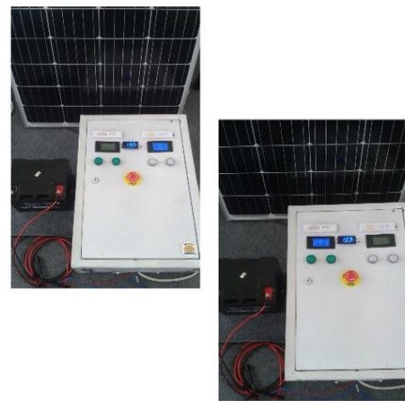
Gambar 6 Box pintu panel
