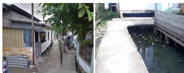
Gambar 4 Kondisi Terjadinya Sedimentasi dan Penumpukan Sampah Pada Sistem Drainase.
