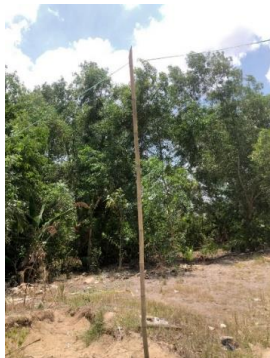
Gambar 16. Tiang Listrik Kayu Diolah Oleh Penulis, Tahun 2023
