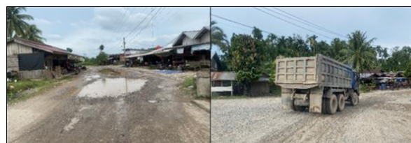
Gambar 2. Kondisi Jalan Jalan Paya Bakong – Pante Bahagia dan Tonase yang Melintasi
