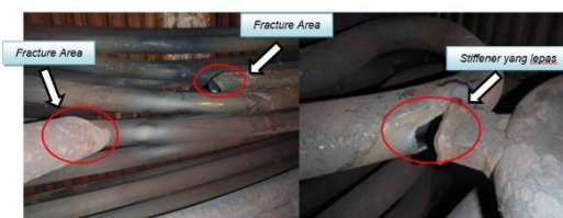
Gambar 2. Fracture area di superheater tube yang gagal.
