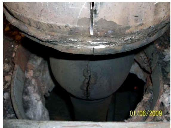
Gambar 3. Lokasi kerusakan Riser Tube Top row 5 pada area RF 9
