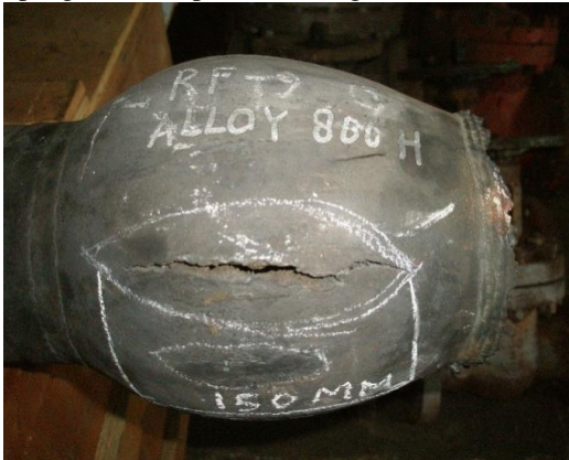
Gambar 5 . Kondisi crack sebanyak 2 ea dengan panjang sekitar 150 mm dan 75 mm
