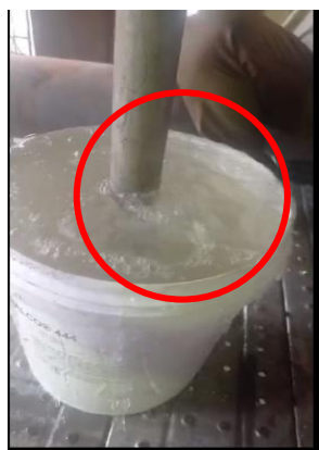
Gambar 5 Fenomena gelembung udara yang keluar dari vent piping line hot water interstage cooler 4A-130-JC.
