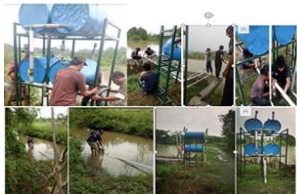
Gambar 8 Instalasi Pompa Vachydram dan pemipaan.
