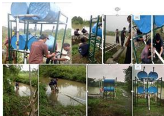
Gambar 8 Instalasi Pompa Vachydrum dan pemipaan. Pengoperasian pompa vachydrum
