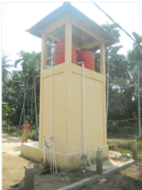
Gambar 3. Bangunan instalasi pompa air dengan sumur artesis
